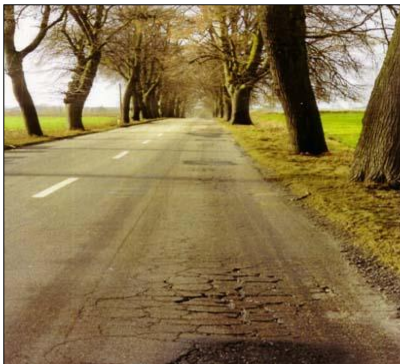
Rys. 3.4. Spękania typu „z dołu do góry” („ bottom – up ”) o charakterze siatkowym na DW Nr 222 (fot. Katedra Inżynierii Drogowej Politechniki Gdańskiej, według [13])
