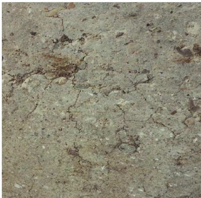
Rys. 6.14. Widok mikrospękań w wykonanej podbudowie [10]
