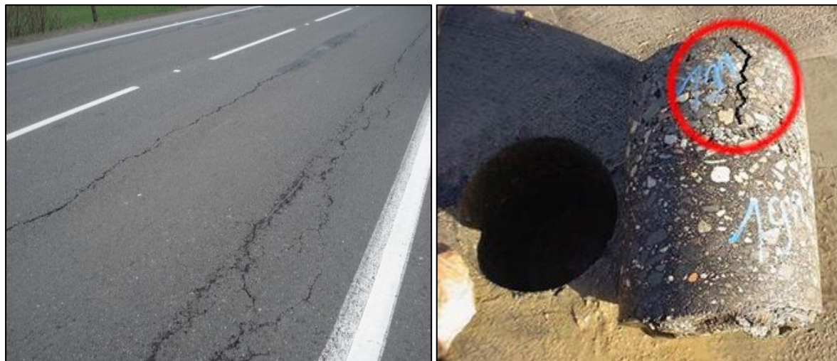
Rys. 3.5. Spękania typu „z góry na dół” o charakterze liniowym na DK Nr 1 (fot. Katedra Inżynierii Drogowej Politechniki Gdańskiej, według [13]) – na odwiercie widać penetrację spękania w dół na kilka centymetrów.
